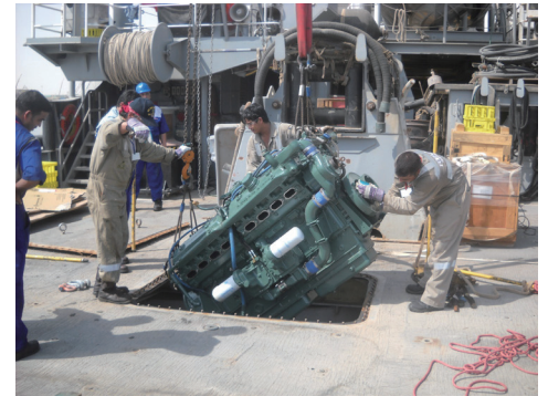
为USNS Catawba号提供电力的3台发电机之一。
